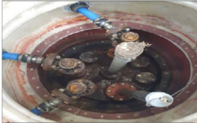
[맨홀 상부 배관]
