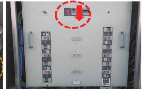
[전기시설 분전반 누전차단기 수동차단방법]
